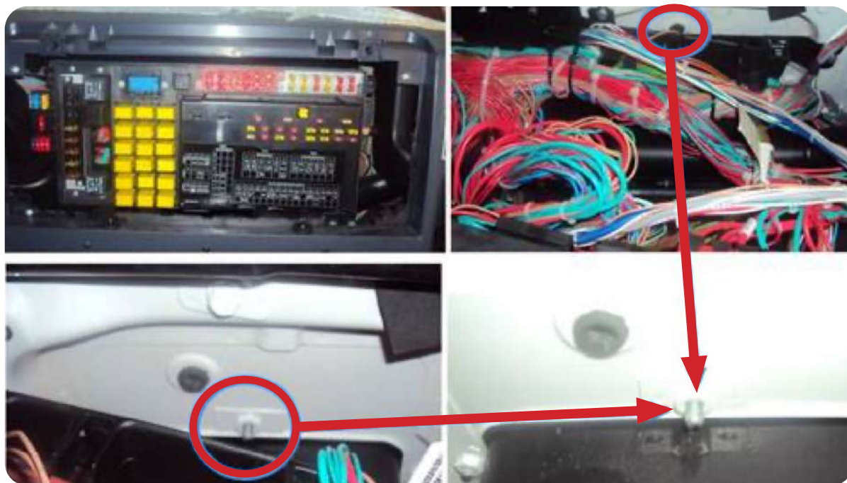
Borne negativo Interno cabine
